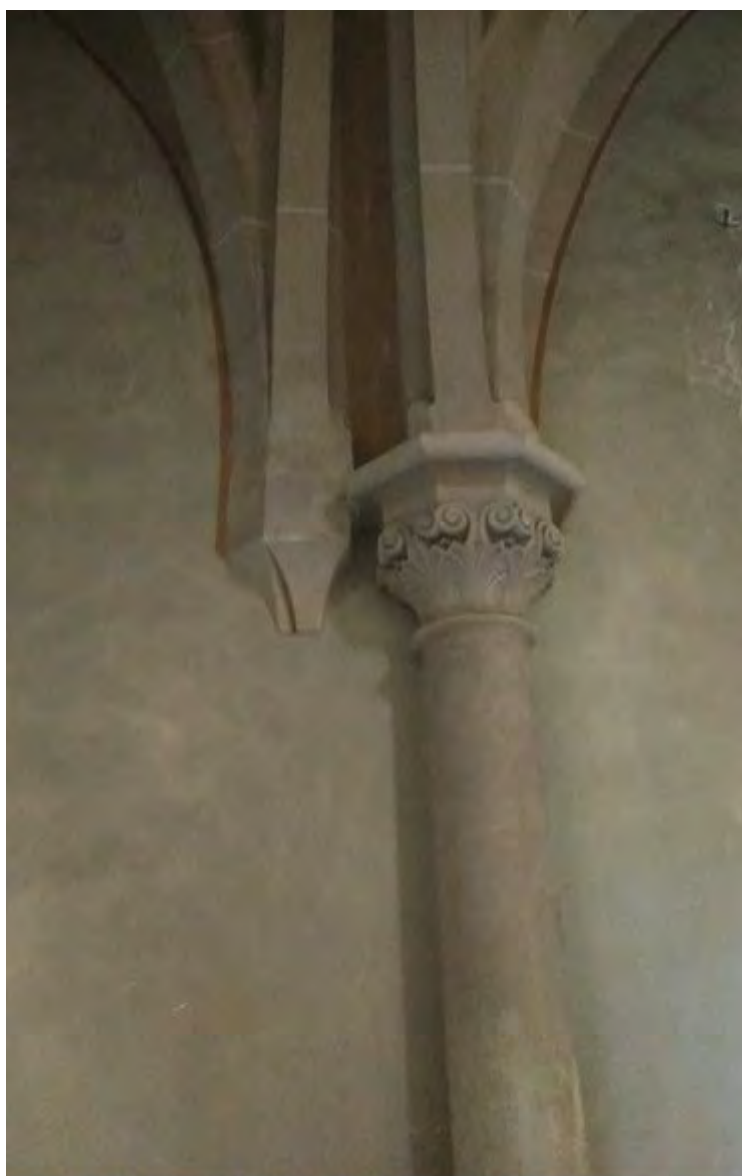
NEDOSEDNUTÍ KLENBY V PORTA COELI (JESTLI TO JE OPRAVDU TAM...)
